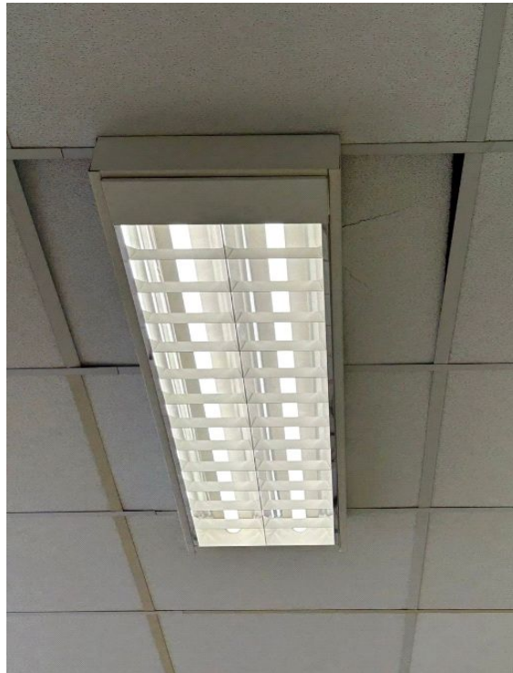
Foto 3 - Luminárias apresentando desprendimentos em seus engates, com risco de queda.
