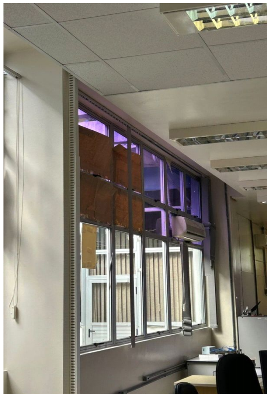
Foto 4 - Janelas sem nenhuma proteção solar adequada.
