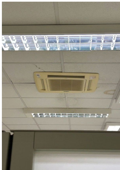
Foto 6 - Forros com presença de infiltração proveniente de chuva.
