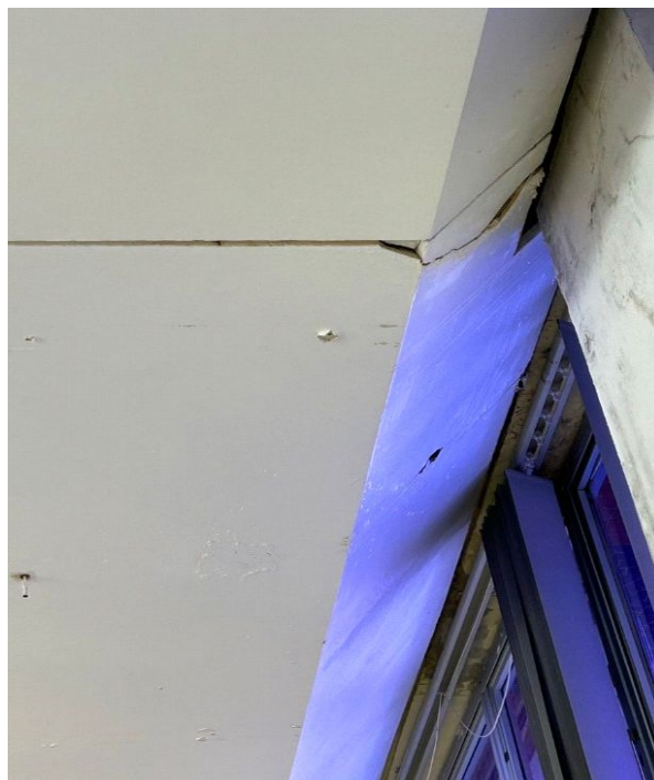
Foto 2 - Forros apresentando rachaduras com risco de queda.
