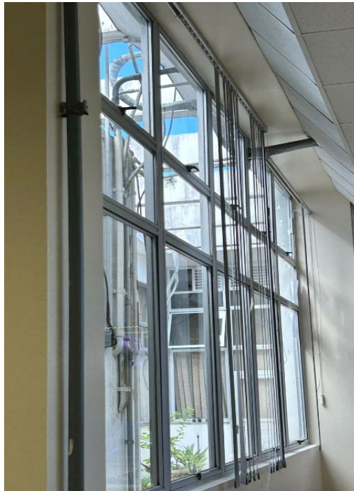
Foto 5 -Janelas com vidro danificado, com problemas de vedação e sem manutenção das cortinas.
