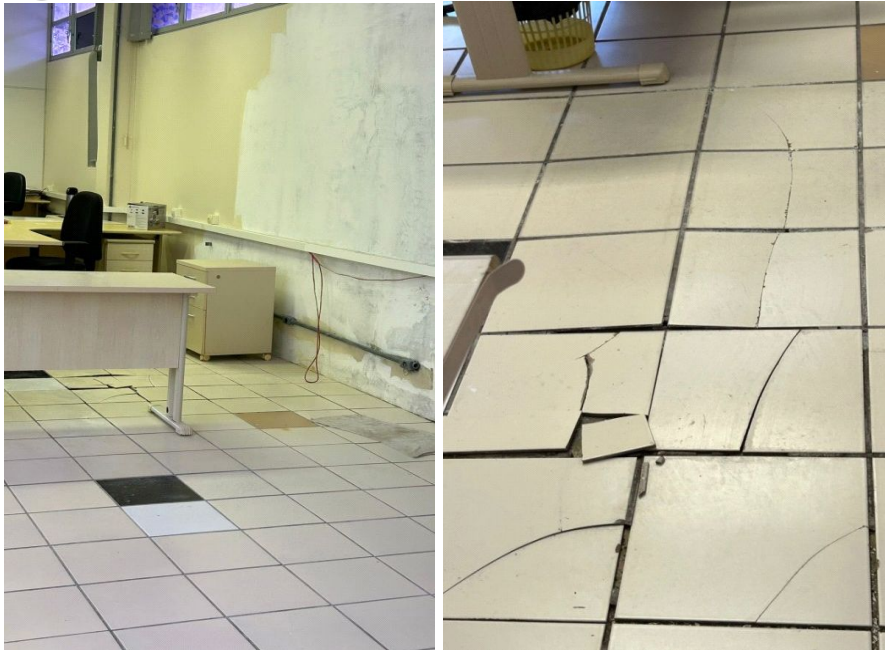
Foto 7 – Pisos soltos e com avarias.
