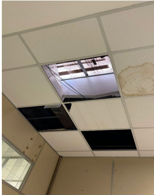
Foto 1 - Telhados com ausência de forro ocasionado por quedas de placas durante a infiltração de água da chuva.
